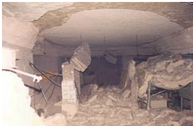
Figure 1 : Exemple d'éboulement du premier banc de toit dans une carrière de calcaire.
