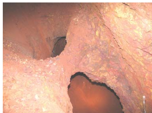
Figure 7 : Dégradation d'un pilier dans une exploitation pentée à May-sur-Orne (14)
