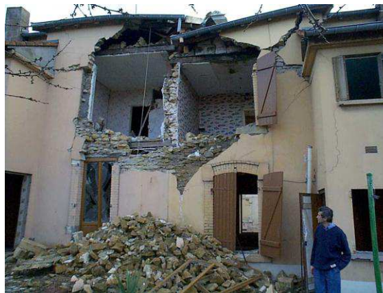
Figure 2 : Dommages causés sur le bâti par les désordres d'Auboué en 1996.
