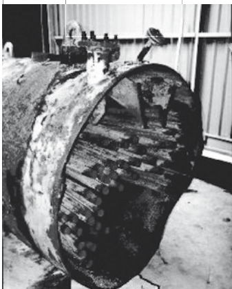
Élément de chaudière propulsé par effet fusée.
