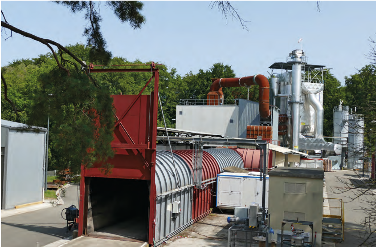
Figure 1 / Galerie incendie (premier plan) et système de traitement de fumées (arrière-plan).
