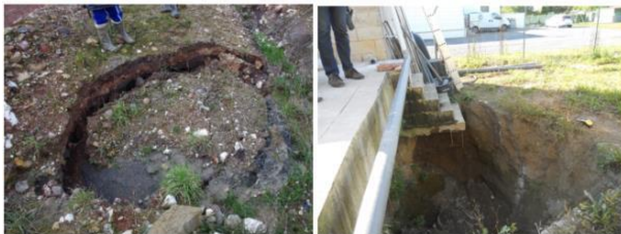
Figure 2. Exemples d'effondrements localisés au droit de cavités d'origine anthropique – source : Ineris
